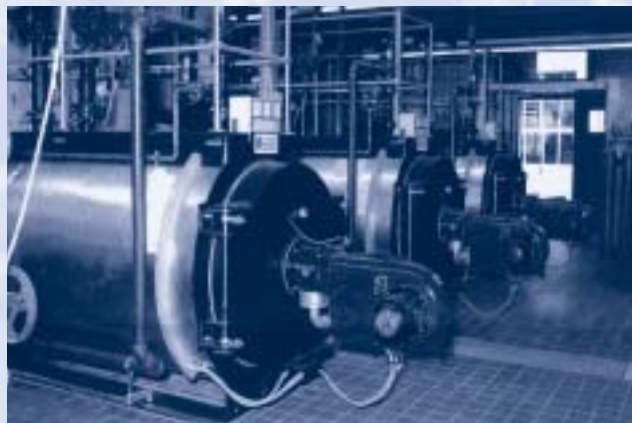
Die neue Kesselanlage mit einer Leistung von 3600 kW
